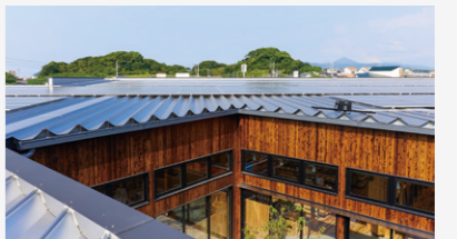
「無印良品 唐津」太陽光発電設備
